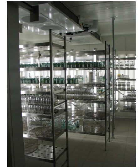
Kühlräume 2 °C und 10 °C
